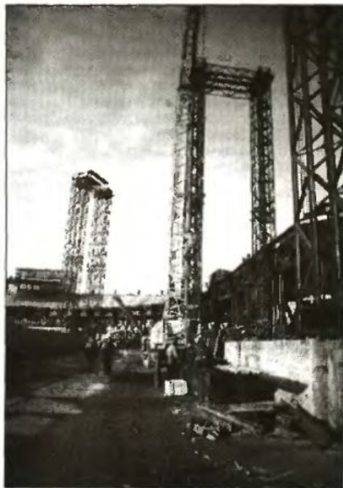
Так выглядела чаша стадиона в Лужниках в ноябре прошлого года. Видны элементы внутреннего пояса и монтажные колонны, на которые был поднят пояс.
